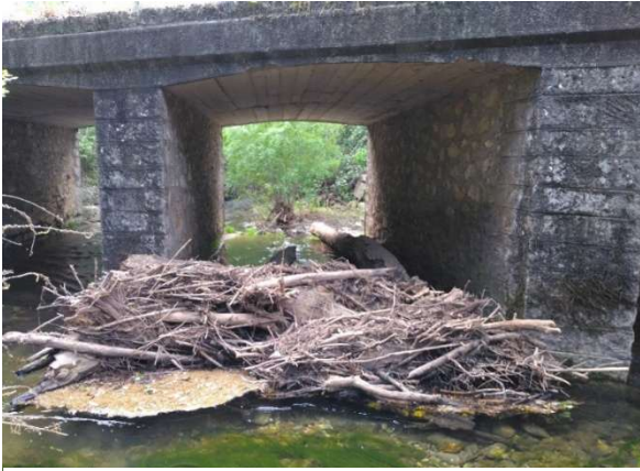
Figure 7 : Exemple de début de formation d'un embâcle sous un pont
